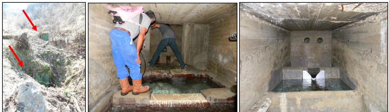
Fig.6.2 – Sorgente Vena d'Acqua. A sinistra; i due bottini di presa. Al centro: particolare dell'opera di captazione a quota superiore (Vena d'Acqua 1). A destra: particolare dell'opera di captazione a quota inferiore (Vena d'Acqua 2)
